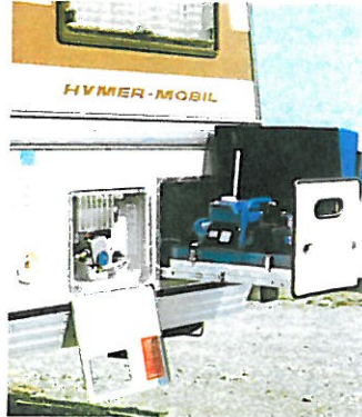
Generator und Heißwasserboiler
