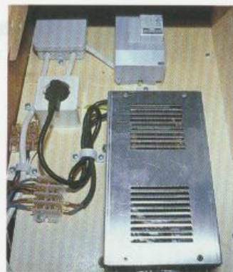
Ladegerät und Sicherungsautomat.
