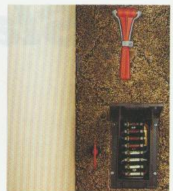
Sicherungskasten, Hauptschalter für Wohnraumelektrik.
