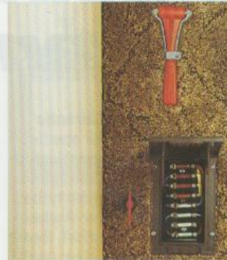
Sicherungskasten, Hauptschalter für Wohnraumelektrik.
