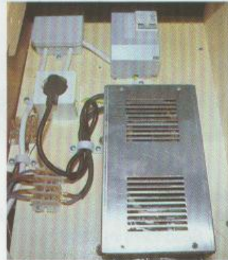
Ladegerät und Sicherungsautomat.
